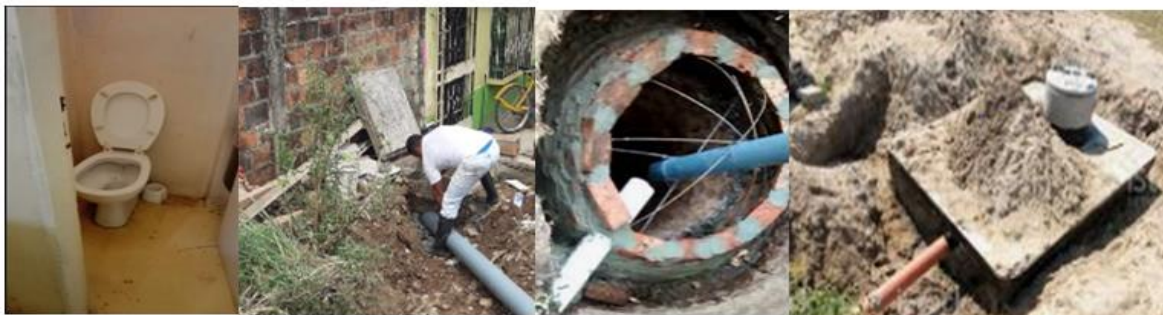
Excusado conectado a pozo ciego
